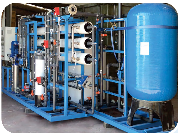
Instalación compacta de ósmosis inversa SETA en una explotación agrícola.
